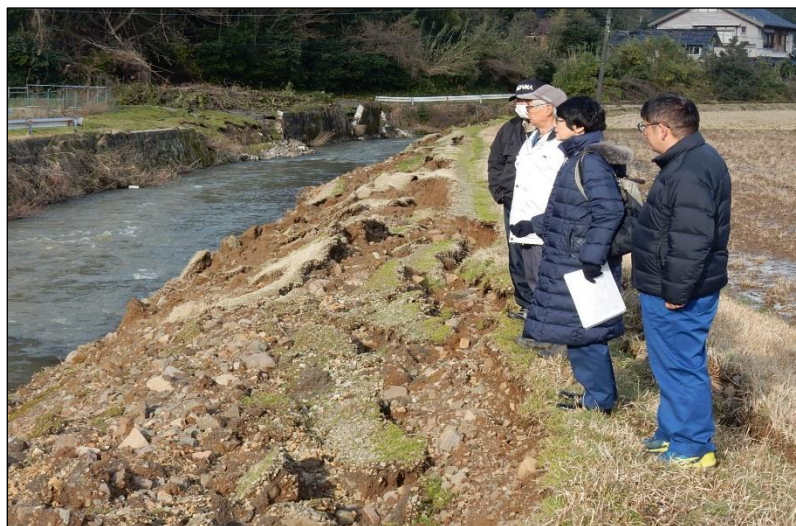
輪島市内の農地に隣接する崩壊した河川法面
