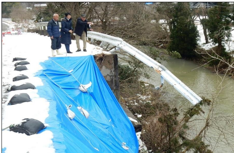
石川県能登町内の県道の下の用水路が崩壊
