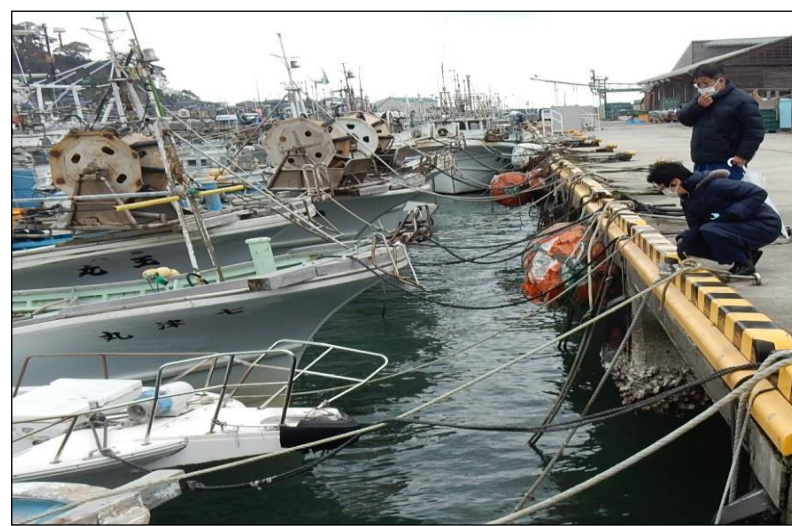
海底の隆起で岸壁が浮上する輪島漁港
